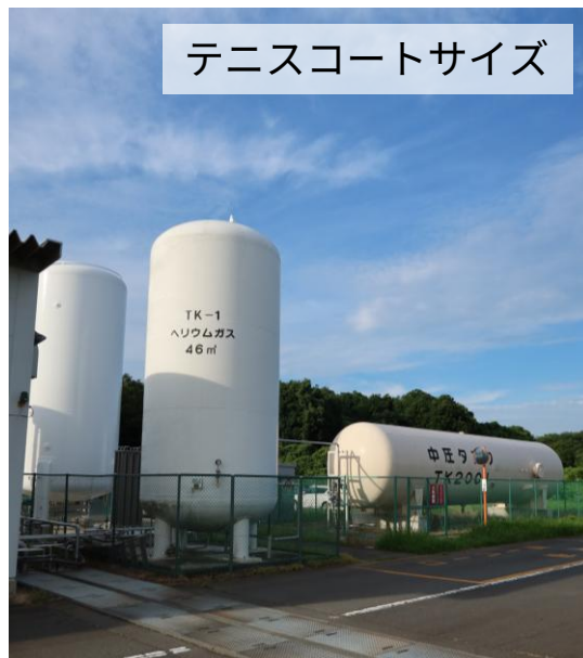
ヘリウムガス貯蔵設備
