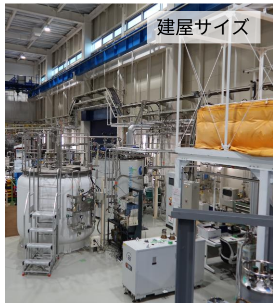
ヘリウム液化設備
